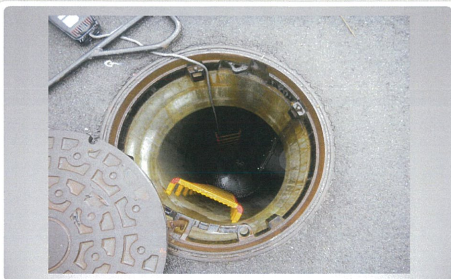
地下水採水箇所
