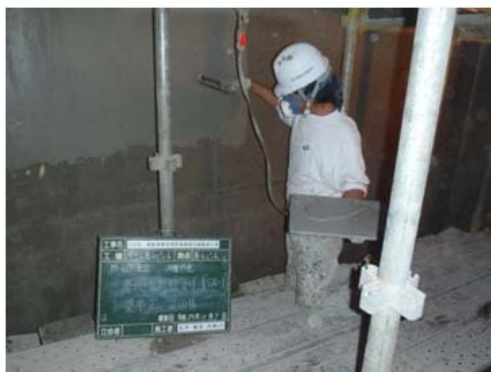
⑦防食塗装(内側) 施工状況 水張り試験後、槽内の清掃を行う。続けて槽内側の表面の平滑さを確認した後、防食塗装を施す。
