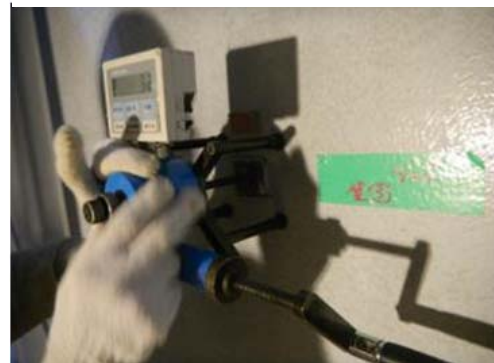
⑦防食塗装(内側) 完了検査 防食塗装の塗膜強度確認状況。この他、仕上がり、塗膜厚さを確認する。
